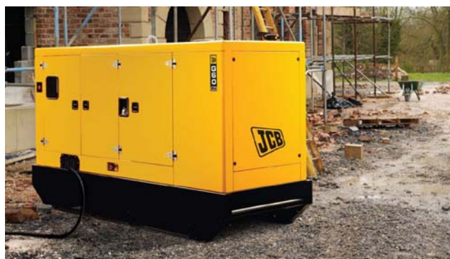
Rys. 3. Zespół przewoźny 60 kVA w wykonaniu napowietrznym ustawiony na placu budowy
